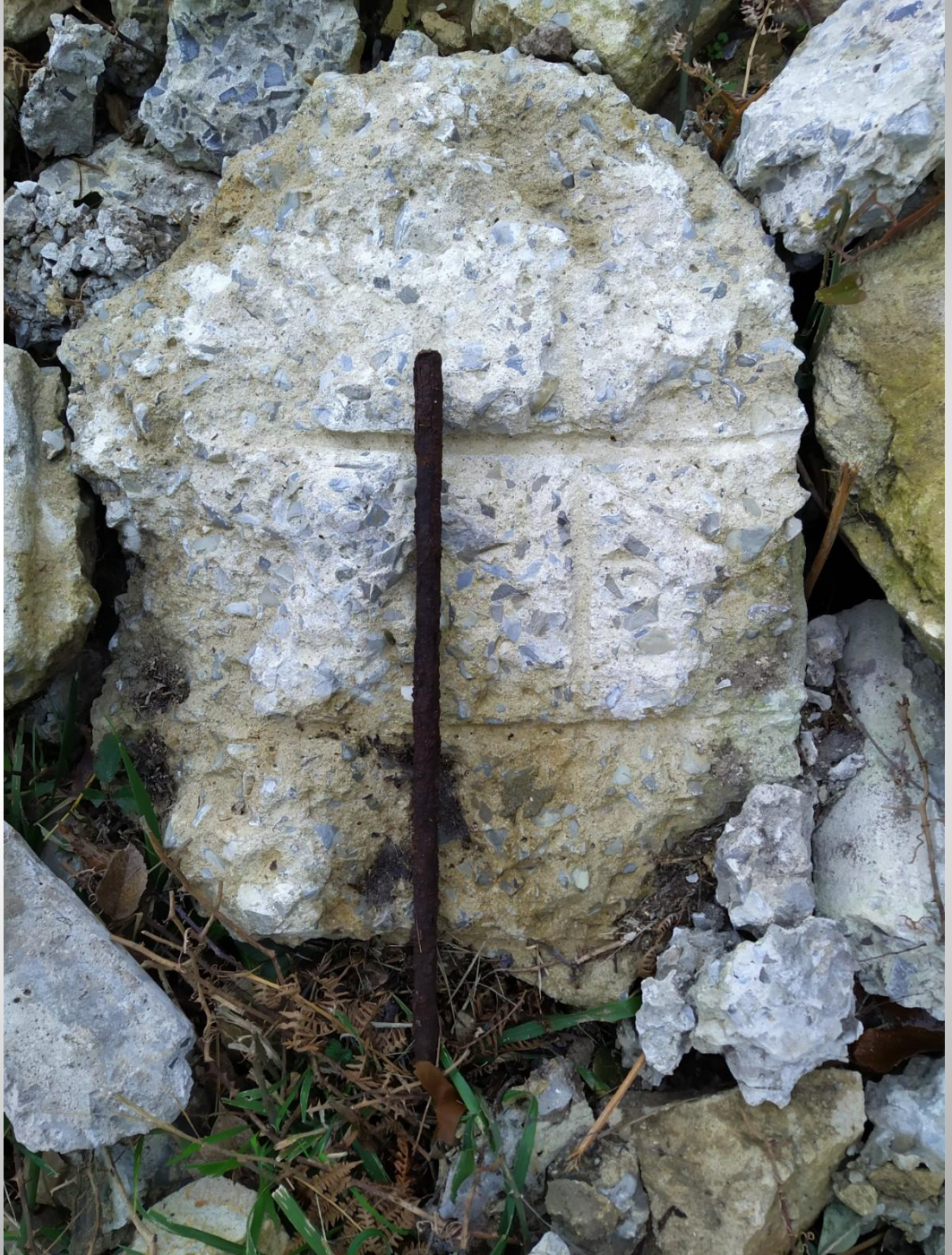
Hormigón del techo con las improntas de las varillas y una de ellas.
